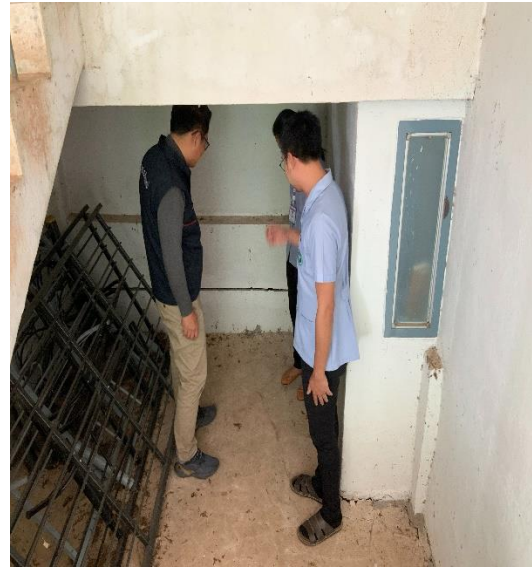
รอยร้าวแยก เนื่องจากพื้นวางบนดินทรุด
